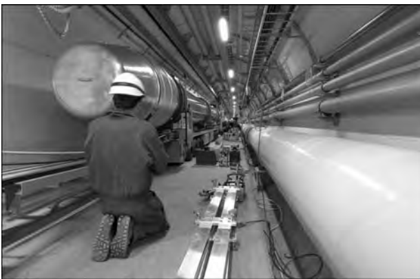
Fig. 1 : Installation de l'un des aimants du LHC dans le tunnel de l'accélérateur
